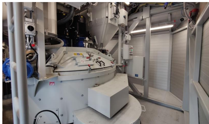
Abbildung 2 Planetenmischer in Betonmischanlage.
