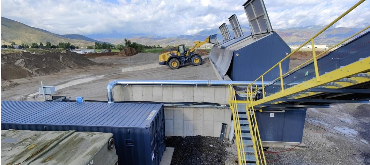
Abbildung 3 Isolierte und beheizte Zuschlagstoffbehälter, vorbereitet für den Winterbetrieb.
